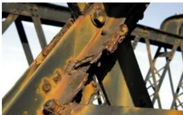
Рисунок 1 – Коррозия металлической конструкции
