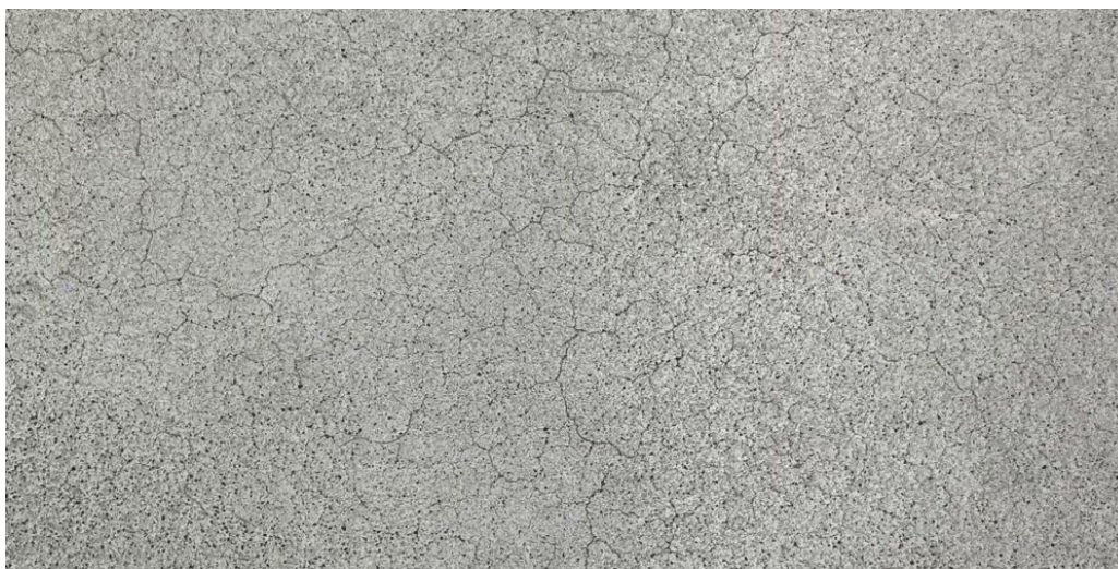
Рисунок 2. Микротрещины на бетонных полах
